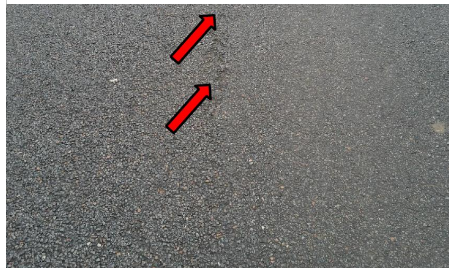
Obrázek 11: Ztráta asfaltového tmelu z povrchu obrusné vrstvy sekce B
